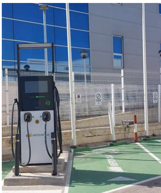
Plazas de vehículos eléctricos
